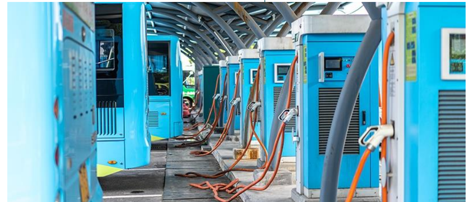
Ladeinfrastruktur einschließlich Ladepunkte für Elektromobilität.
